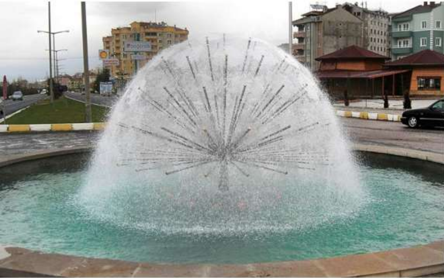
Nevşehir Belediyesi Küre Fıskiye Sistemi
